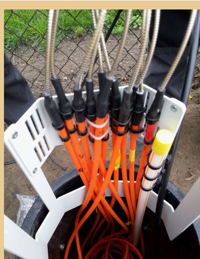
Fot. 2. Prefabrykowane kable DAC w słupku dystrybucyjnym 3F
